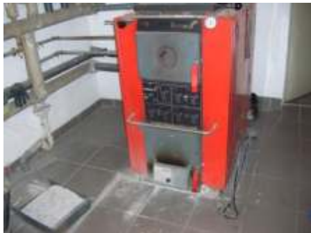
Gesamtbild vom Kessel
